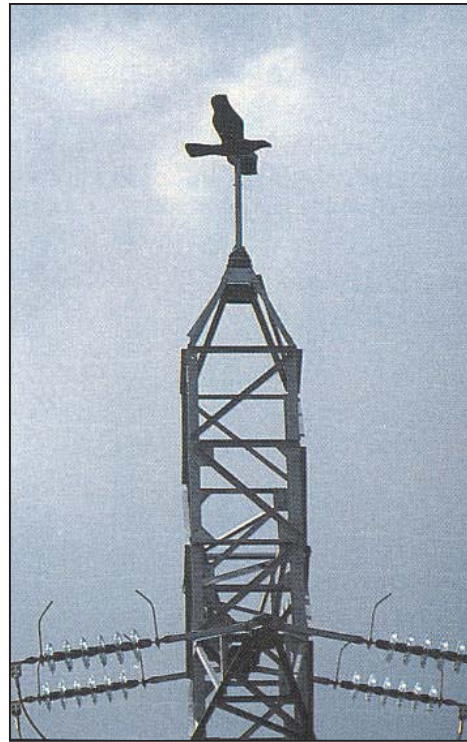
Fig. 3.5. Sagome poste sui pali scoraggiano la nidificazione dei rapaci, rendendo meno probabile l'elettrocuzione sul sostegno.
