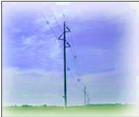
Figura 6.6a. Un palo di sostegno e cavi con visibilità aumentata grazie all'applicazione di spirali (particolare in fig. 6b).
